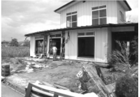
津波で被災した家。再建へ向けて援助
