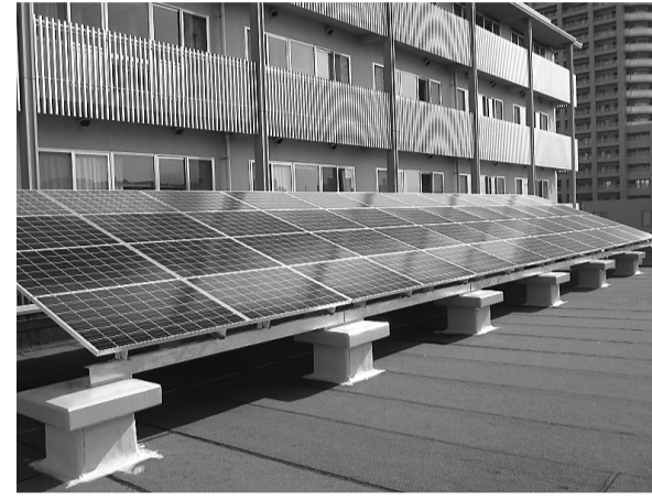
屋上に設置した太陽光パネル
