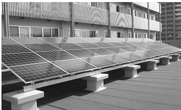
屋上の太陽光発電装置。1カ月で約1,000kWh、平均家庭使用電力3軒分に
