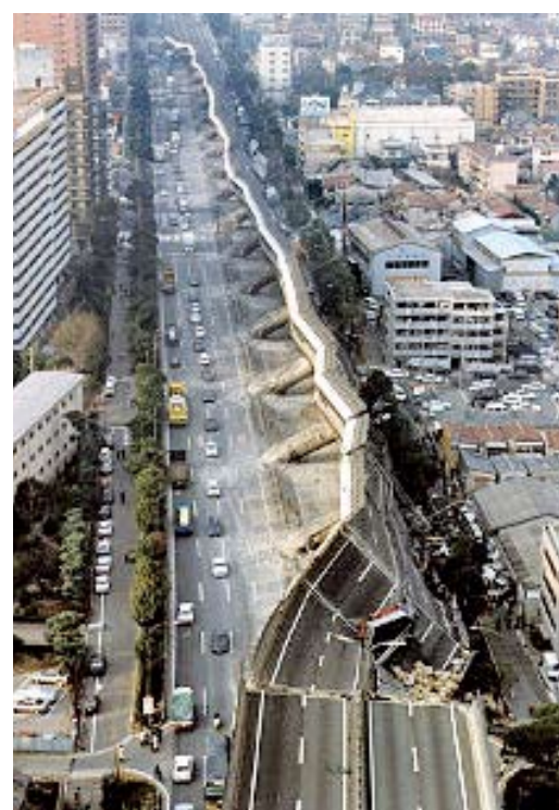
橋脚ごと横転した阪神高速神戸線
